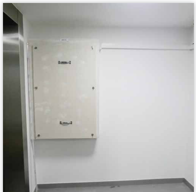
Elektroverteiler vor dem Umbau
