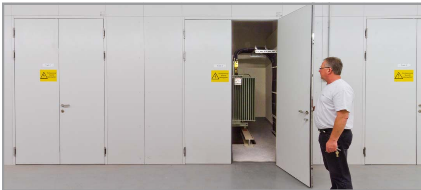
Geöffnete PRIODOOR vor Trafo Nr. 6 von 12
