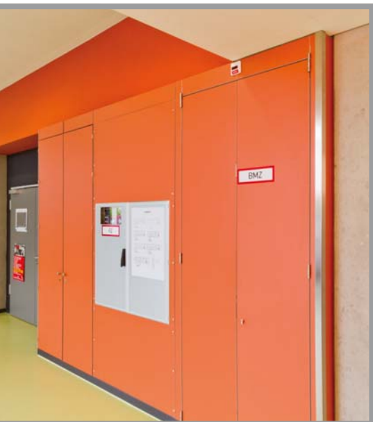
Feuerbeständige Abtrennung der Brandmeldezentrale
