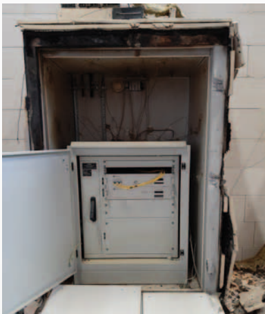
Gehäuse typgeprüft mit eingebauter BOS Anlage – Nach dem Brandtest, Brand von außen, Nachweis des Funktionserhalts über 90 Minuten
