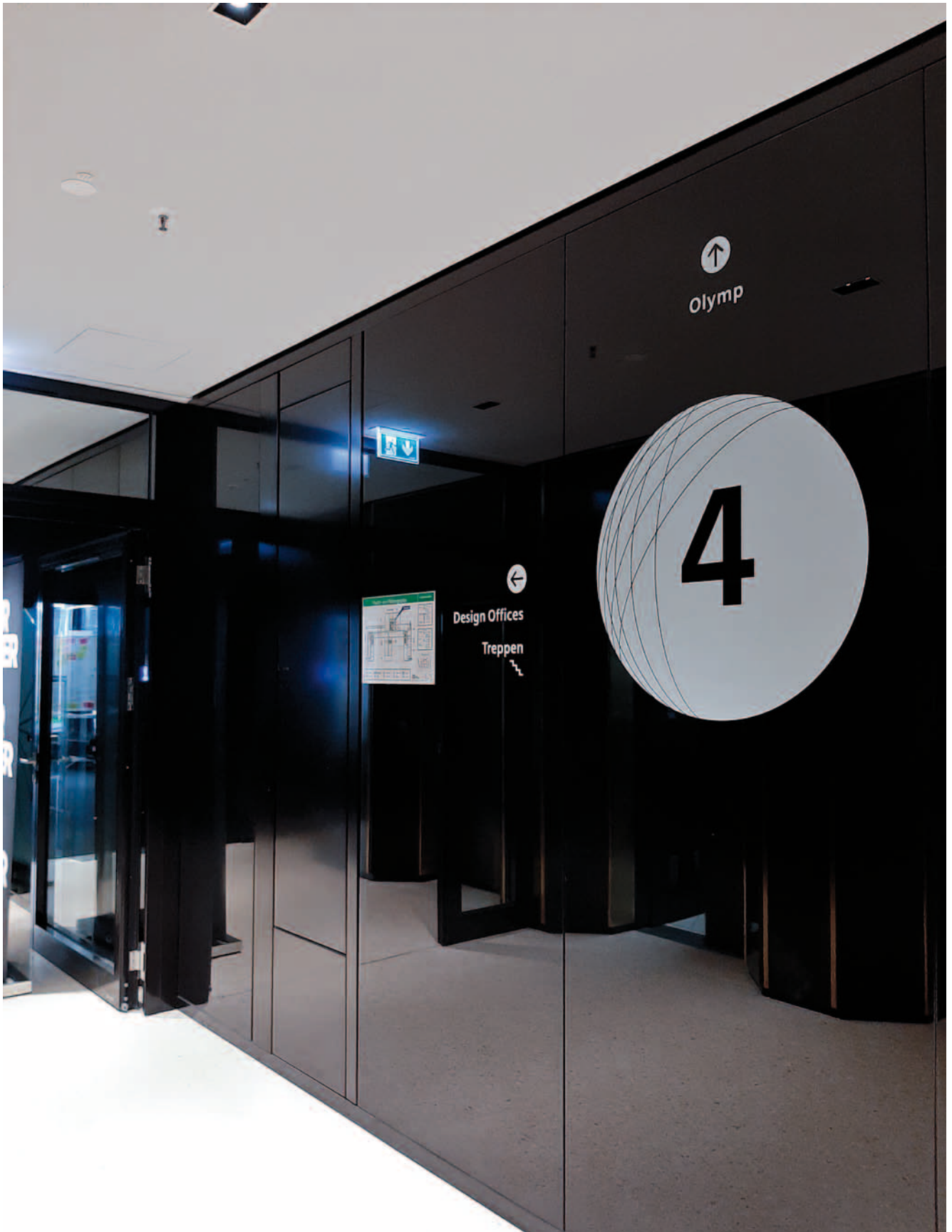
Unauffällige Entrauchungsklappe PRIODOOR ETX RDA mit bauseitiger Verkleidung aus schwarz beschichtetem Blech
