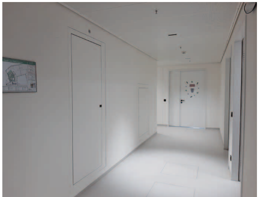
Großformatige Entrauchungsklappe und Revisionsabschluss in einheitlicher Optik, angepasst an die baulichen Vorgaben des Gesamtkonzepts
