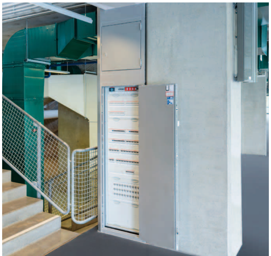
Raumhohe Verteiler im Fluchtwegbereich, feuerwiderstandsfähig abgeschottet
