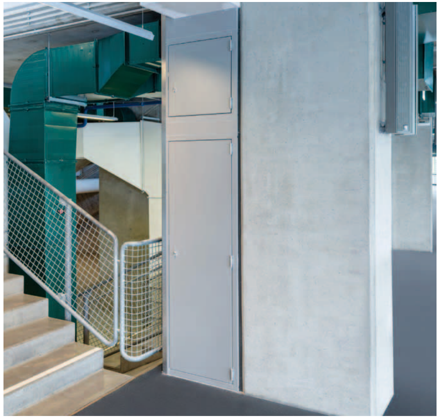
Raumhohe Verteiler im Fluchtwegbereich, feuerwiderstandsfähig abgeschottet
