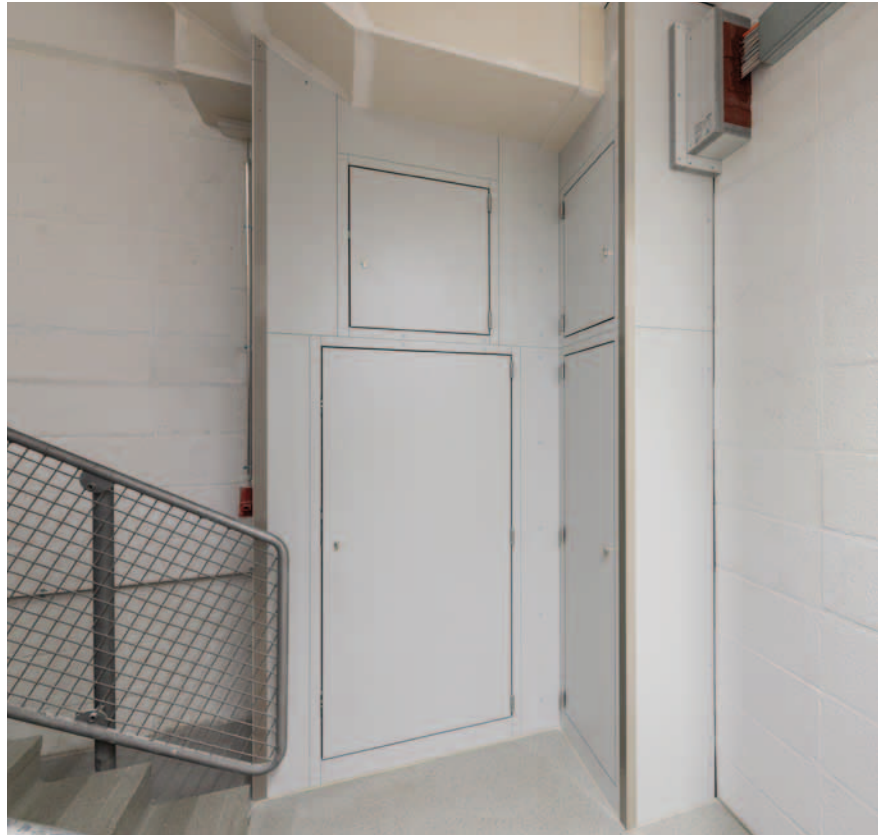
Die Brandentstehungsgefahr der Elektroverteiler wurde brandschutzmäßig sicher gegenüber den Treppenträumen abgetrennt.
