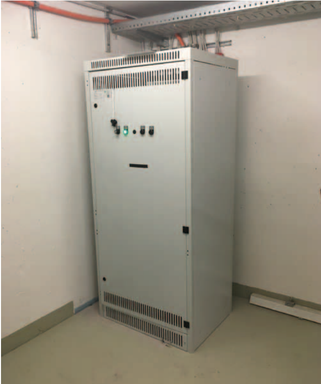
Elektroverteilerschränke im Rettungsweg, vor dem Umbau
