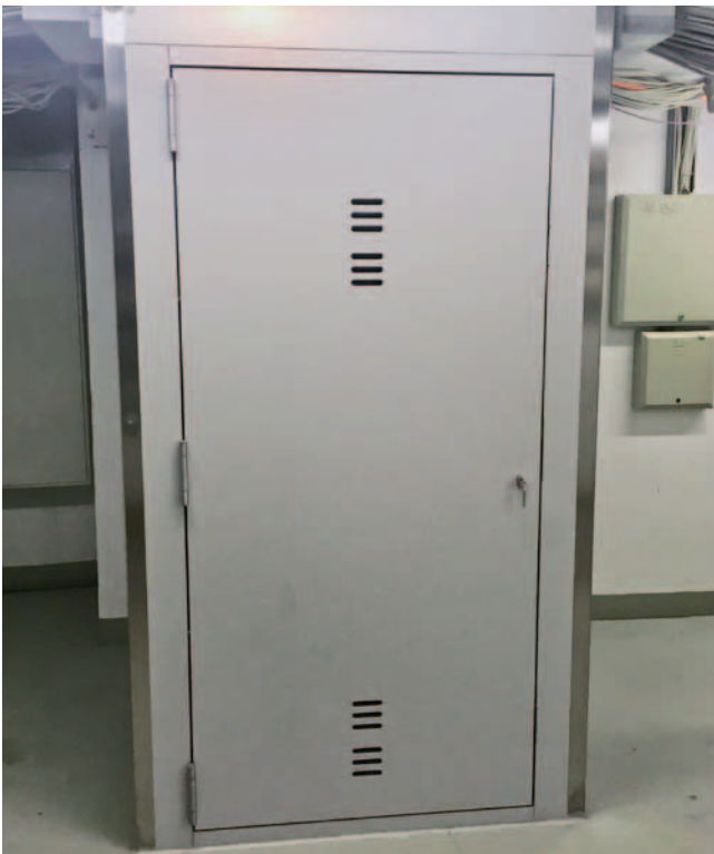
Feuerwiderstandsfähige Einhausung mit Belüftungsöffnungen
