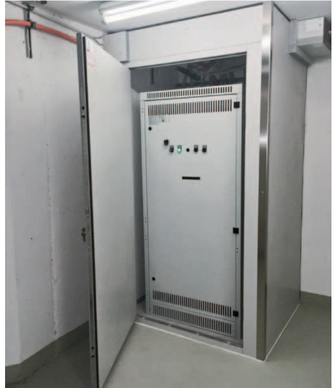
Feuerwiderstandsfähige Einhausung der Elektroverteilerschränke
