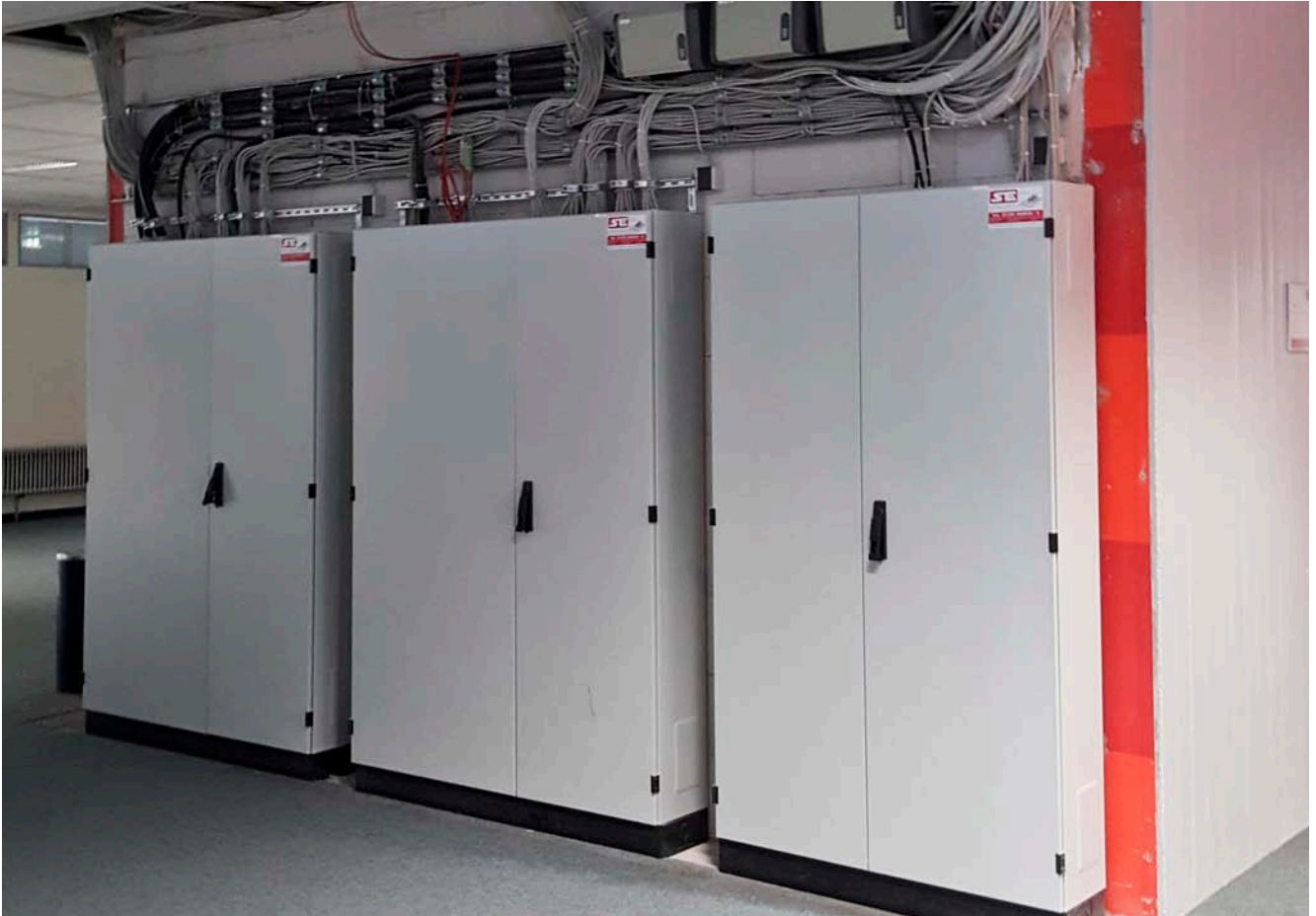
Elektroverteilerschränke im Rettungsweg, vor dem Umbau
