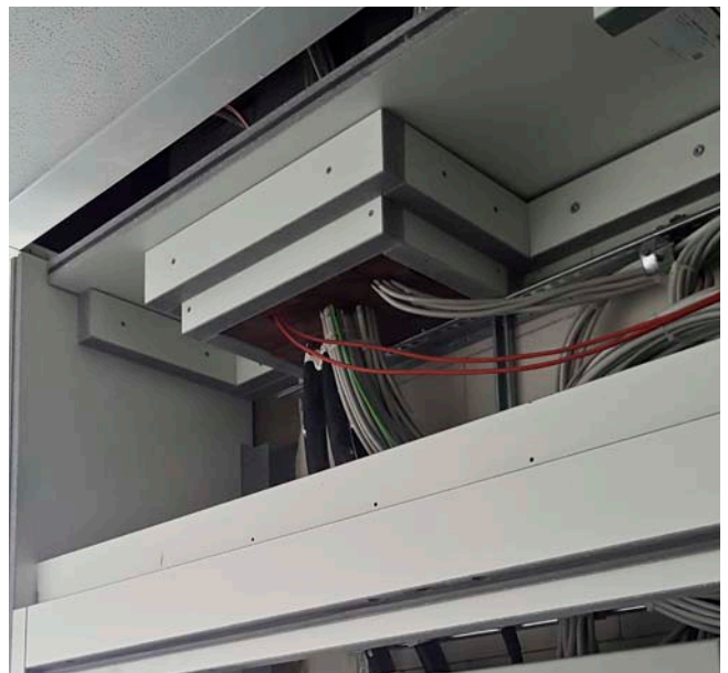
Detailbild: Einhausung mit Decke und Kabelschotts
