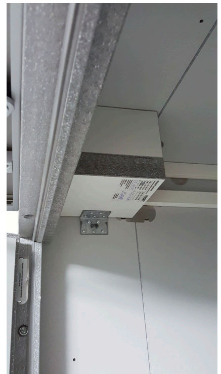
Kabelschott innen, für weitere Kabelbelegung
